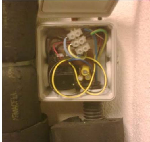
Steuerung mit Relais untergebracht in einer normalen Verteilerdose
